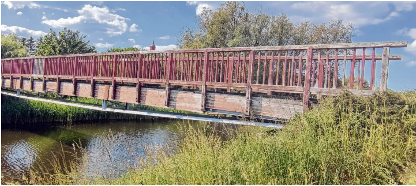
Die Brücke für Fußgänger und Radfahrer über die Tollense am Altentreptower Jungfernstieg entspricht nicht mehr in vollem Umfang den baurechtlichen und sicherheitstechnischen Anforderungen. Eine Sanierung ist dringend nötig. FOTOS: TOBIAS HOLTZ
